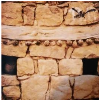
صورة (٩) بلدة Aures بالجزائر - بناء بديل غير مألوف استخدم فيه الخشب مع الحجر لتحسين اداء هيكل الحائط - هذه النظم من التثبيت تتيح الفرصة لاستخدام الاحجار غير المنتظمة الشكل عن طريق الاستبدال بربط السطحين بكتلة مستعرضة لزيادة الثبات والترابط ولمقاومة الزلازل والمخاطر دون احداث خلل فى توازن المبنى.
